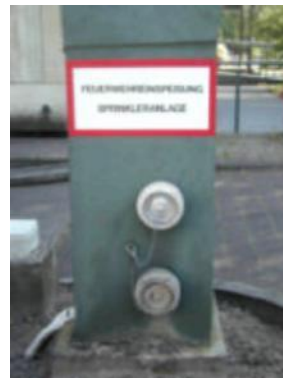
Einspeisung für eine Sprinkleranlage
